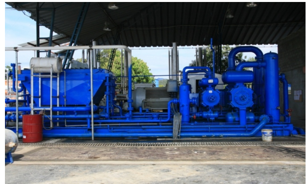
Figura 5. Compresor Worthington en planta.
