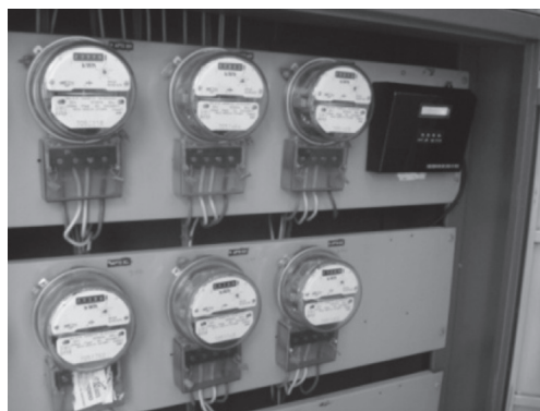
Figura 2. Armario de medidores
