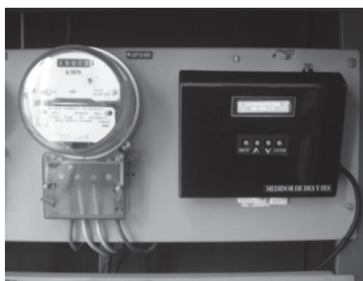
Figura 3. Medidor de energía activa y medidor de continuidad en el servicio de energía eléctrica
