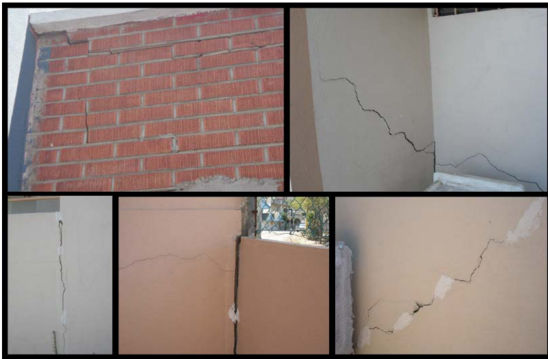
Figura 2. Daños en edificaciones ubicadas en el área de estudio
