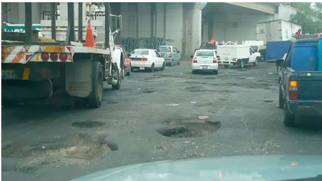
Figura 9. Grave deterioro de pavimento en la metrópoli de Guadalajara
