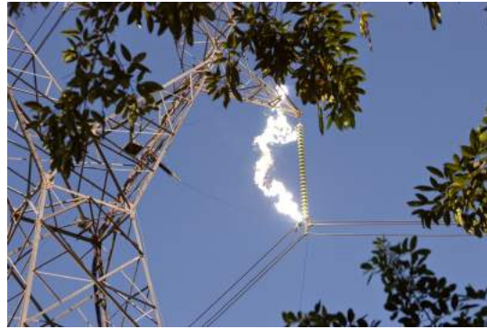
Figura 2. Arco eléctrico en cadena de aisladores
