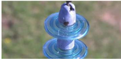
Figura 6. Degradación de aislador por efecto de descargas parciales
