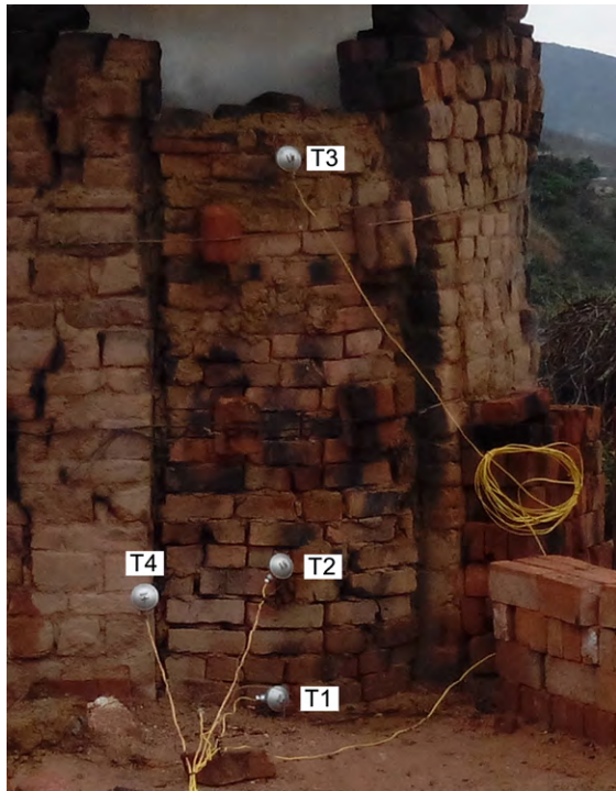
Figura 1. Termopares instalados por niveles en el horno
